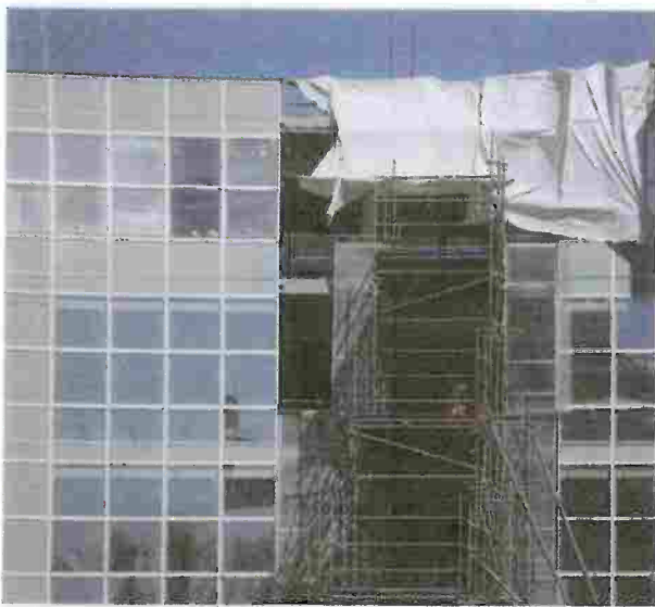
Un mur-rideau gérant les apports solaires est installé sur la façade.
